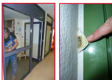
Abb. 5: Überprüfung von Brandschutzportalen (Quelle: MA 39)
