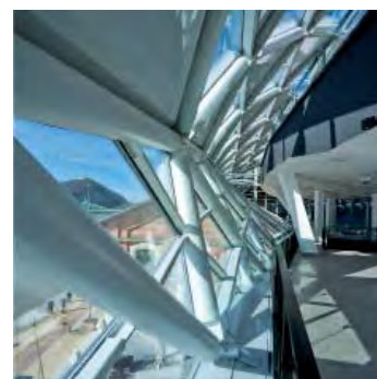
pic_08: Die beschichtete Stahlkonstruktion erfüllt die Brandschutzanforderung E (G) 30.
