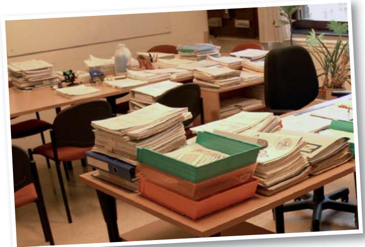
Abbildung 2 zeigt einen Büroraum, der ungeeignet für einen sicheren Verweilbereich im Sinne der o. a. Erleichterungen ist, da eine erhöhte Brandlast (lose liegendes Papier) vorhanden sowie die erforderliche Stell- und Bewegungsfläche für RollstuhlfahrerInnen fehlt.
